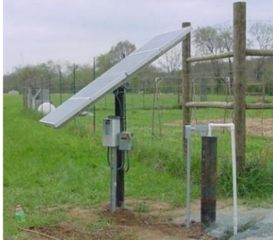
Figura 10 – Sistema de bombeamento fotovoltaico.
