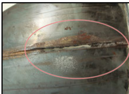
Figura 21 - Exemplo de vazamento de solda
