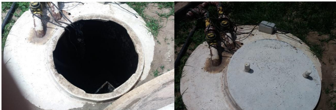
Figura 9 - Imagem do sistema de tratamento compacto do Condomínio Praia dos Arrecifes
