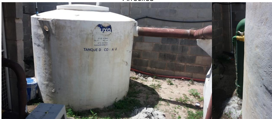
Figura 8 - Imagem do sistema de tratamento compacto do Condomínio Praia dos Arrecifes
