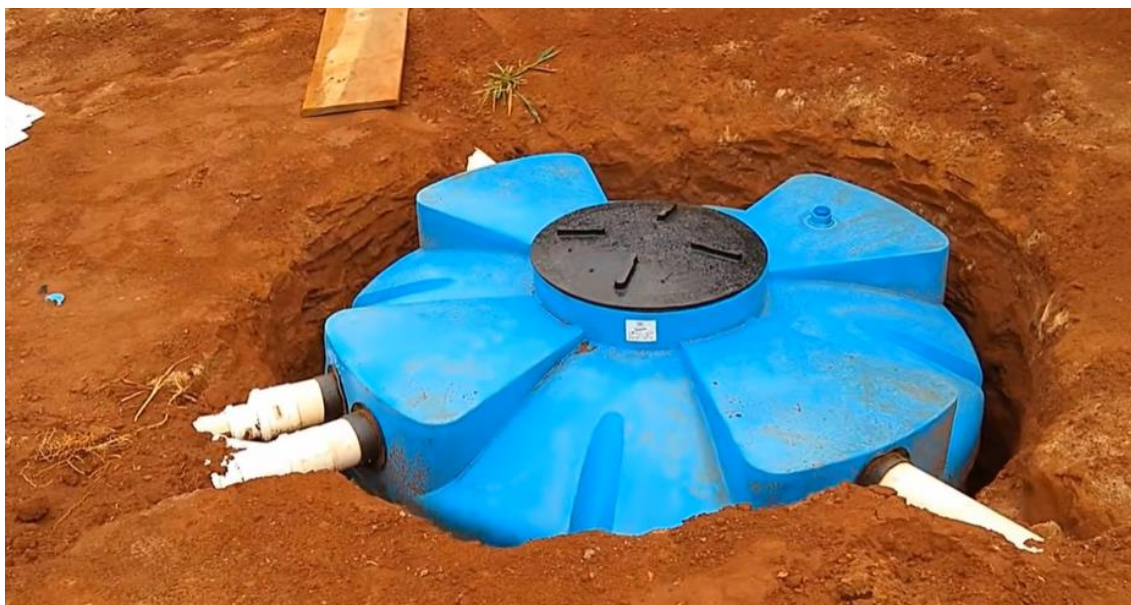
Figura 19 – Exemplo de um reservatório subterrâneo
