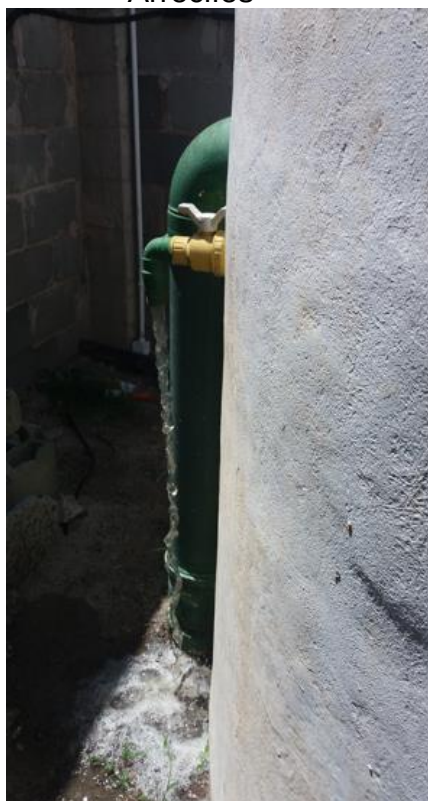
Figura 20 – Imagem do sistema de tratamento compacto do Condomínio Praia dos Arrecifes
