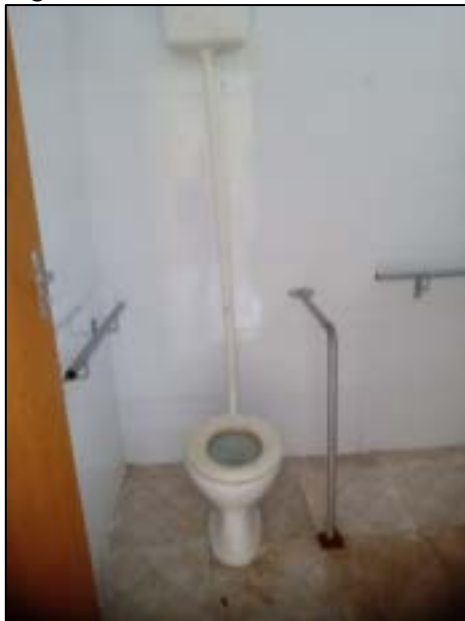
Figura 21 – Banheiro do Dormitório
