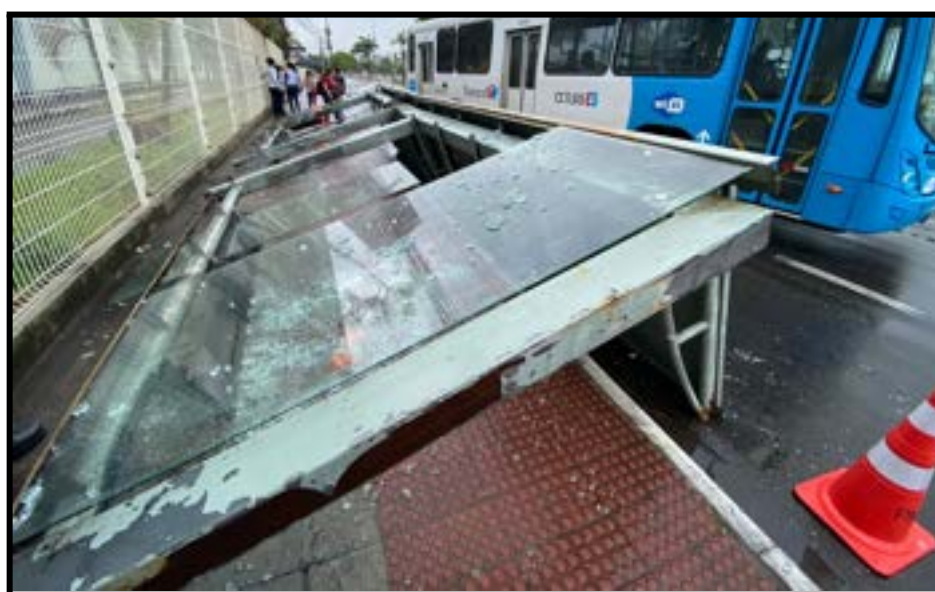
Figura 26: Abrigo de ponto de ônibus caído em Vitória
