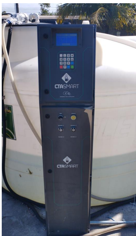
Imagem 2 – Totem para automação da bomba de combustível do tanque interno
