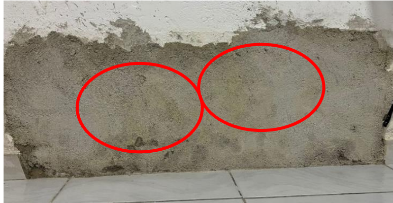
Figura 9 – Parede apresentando manifestação patológica do tipo mofo
