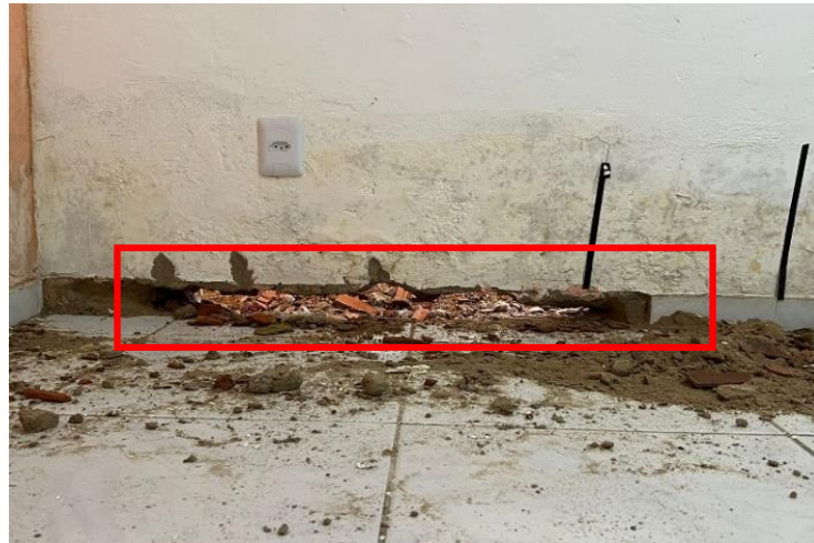
Figura 3 – Local da parede onde foi quebrada de um lado ao outro
