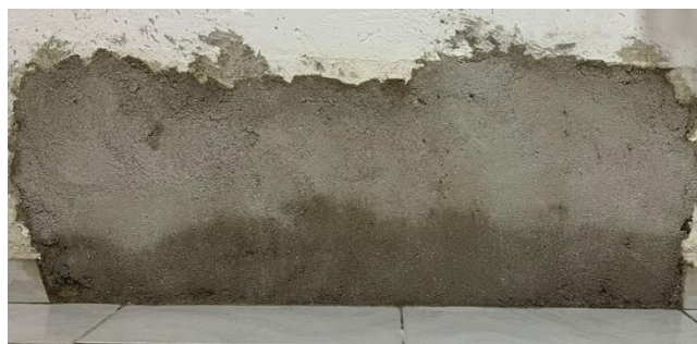
Figura 8 – Parede apresentando infiltração por capilaridade
