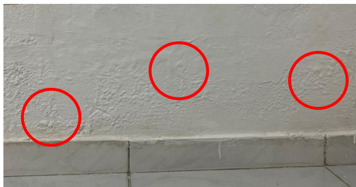
Figura 10 – Parede com presença de vesículas
