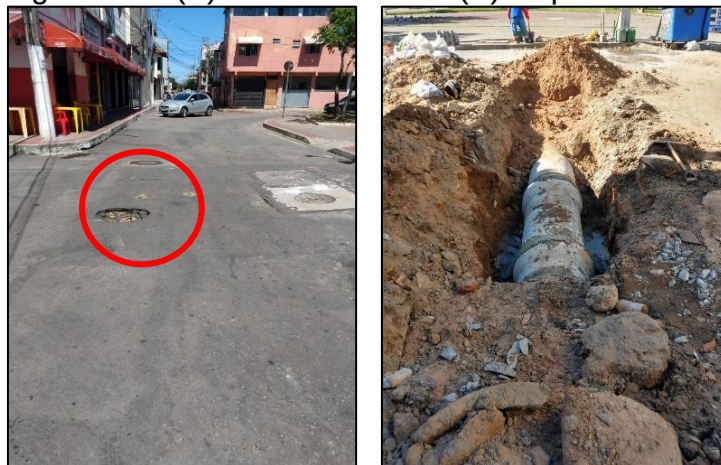
Figura 07 – (A) Via com buraco (B) Reparo na rede
