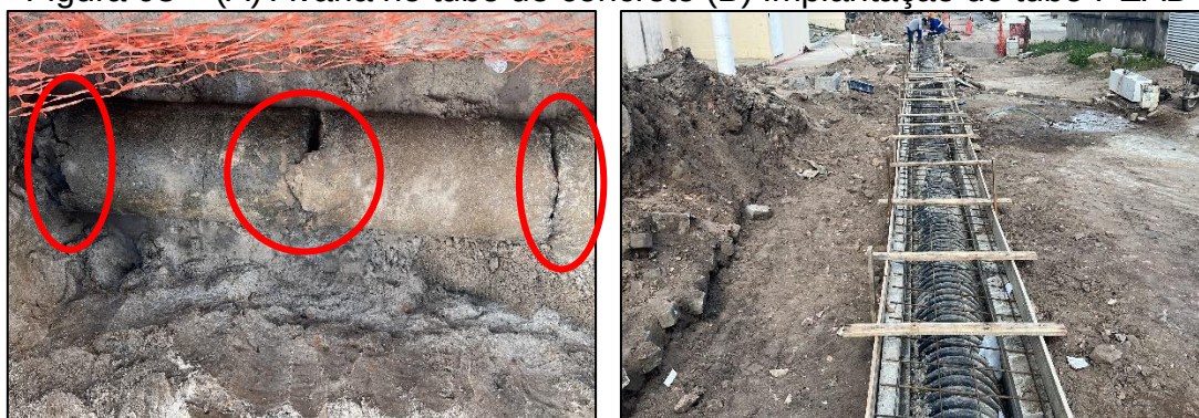
Figura 08 – (A) Avaria no tubo de concreto (B) Implantação do tubo PEAD
