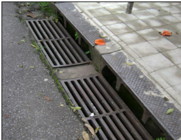
Figura 5 - Boca de lobo
