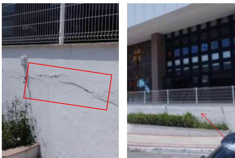
Figura 5 – Presença de trinca na fachada da entrada da igreja
