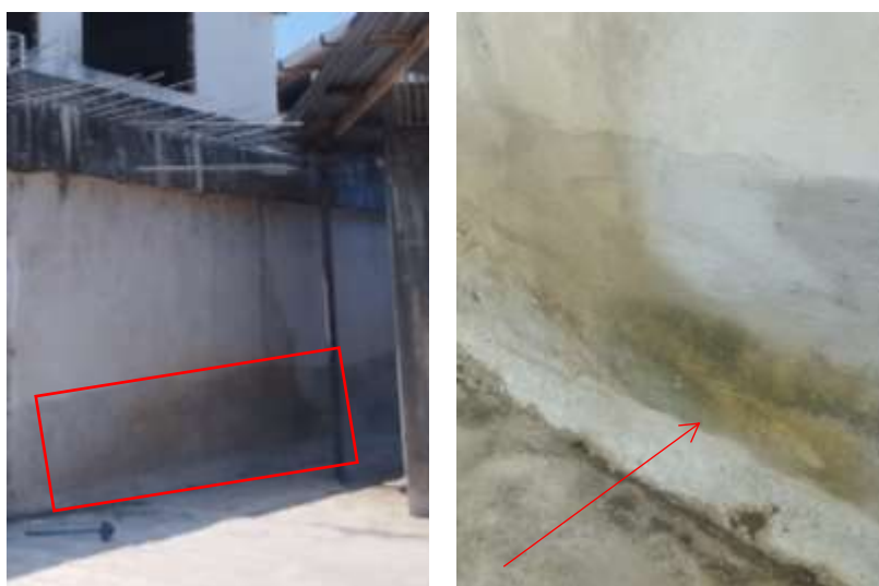
Figura 7 – Presença de umidade na base da parede
