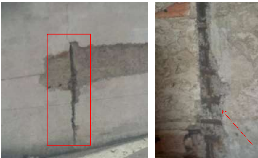
Figura 3 – Presença de corrosão no concreto armado da edificação
