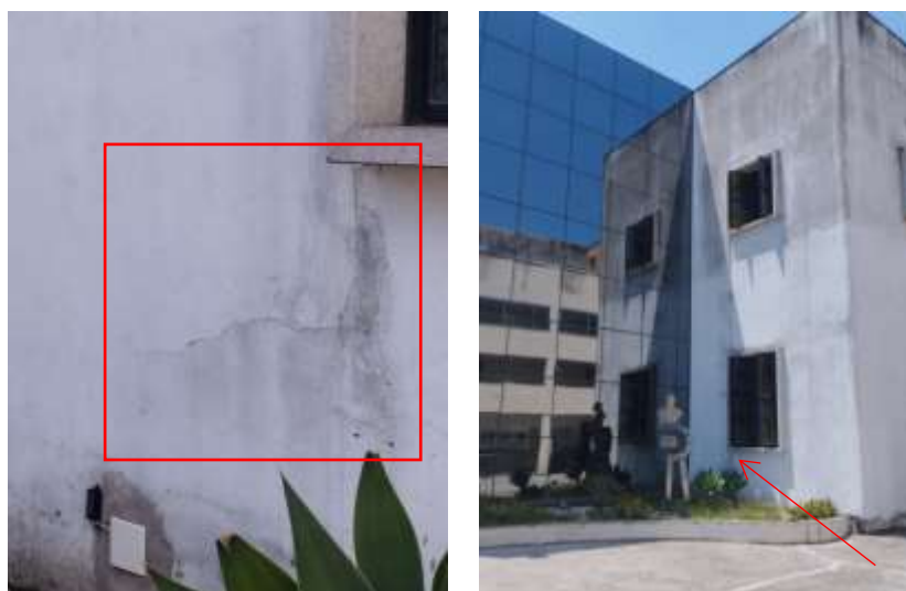
Figura 4 – Presença de fissura na parede abaixo da janela
