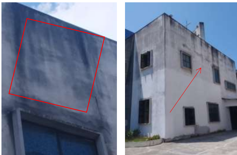
Figura 2 – Presença de manchas, bolor e fungos
