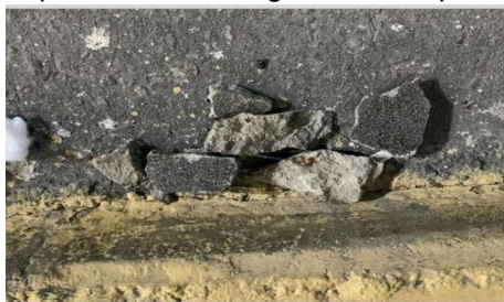
Imagem 02 – Deslocamento de argamassa, arquibancada setor E
